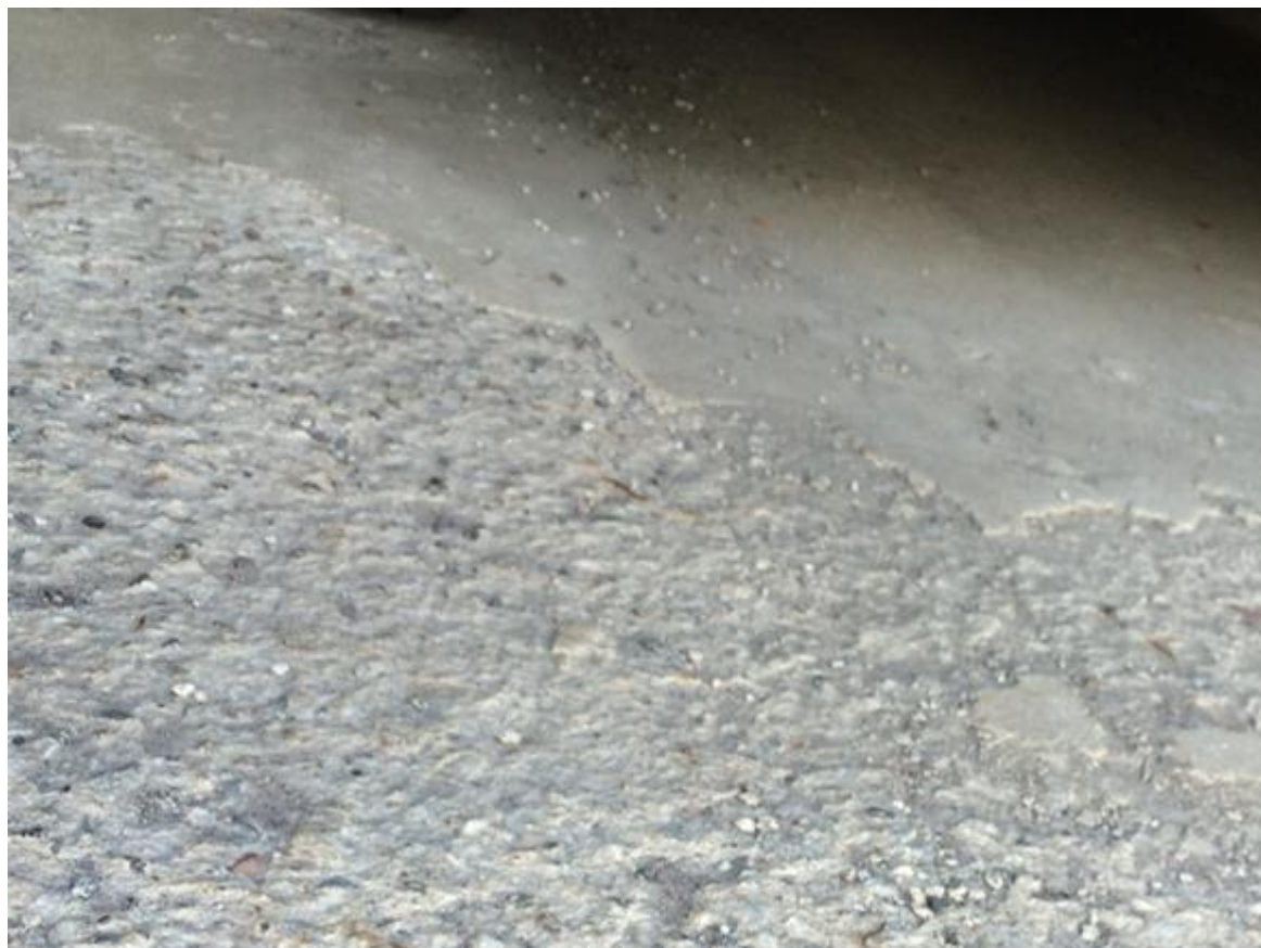
Figur 7-9: Eksempel på overflate skadet av frostsprengning
