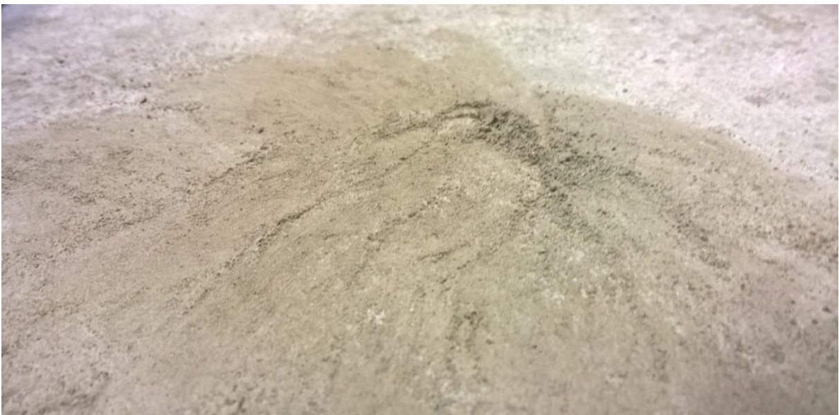
Figur 7-8: Støving i form av «sandaktig» sjikt på grunn av bruk av uegnet herdemembran
