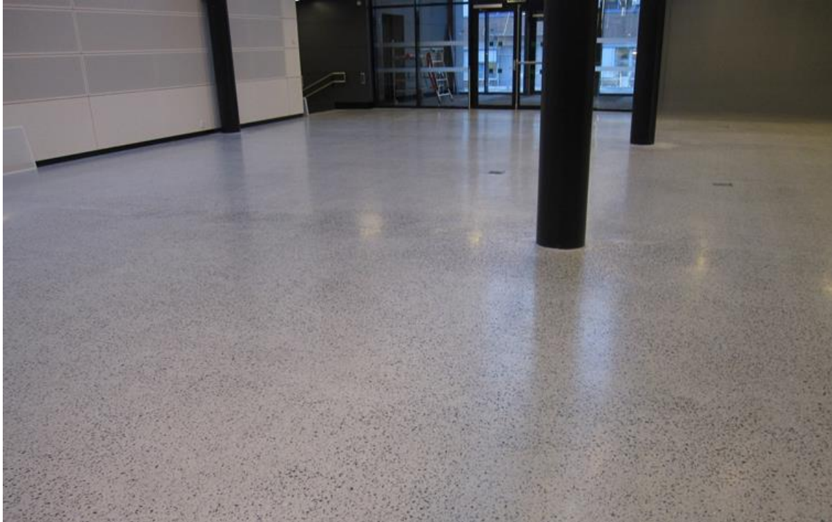
Figur 7-18: Slipt og polert betongoverflate
