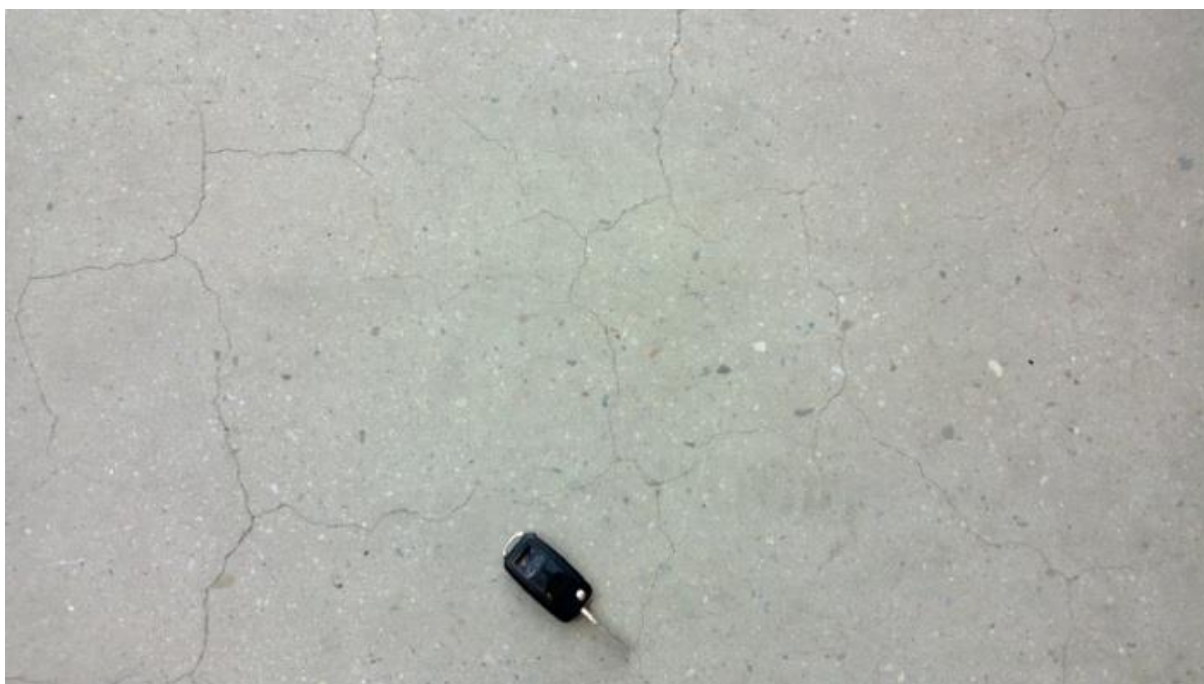
Figur 7-2: Plastiske svinnriss som er kommet til syne etter sliping
